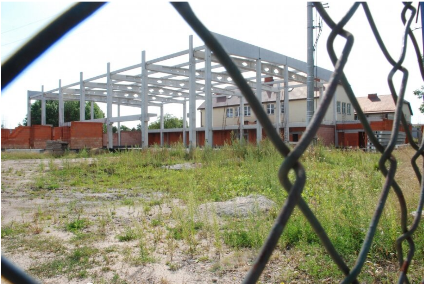
Plac budowy zarasta chwastami. (fot. Beata Pierzchała)
