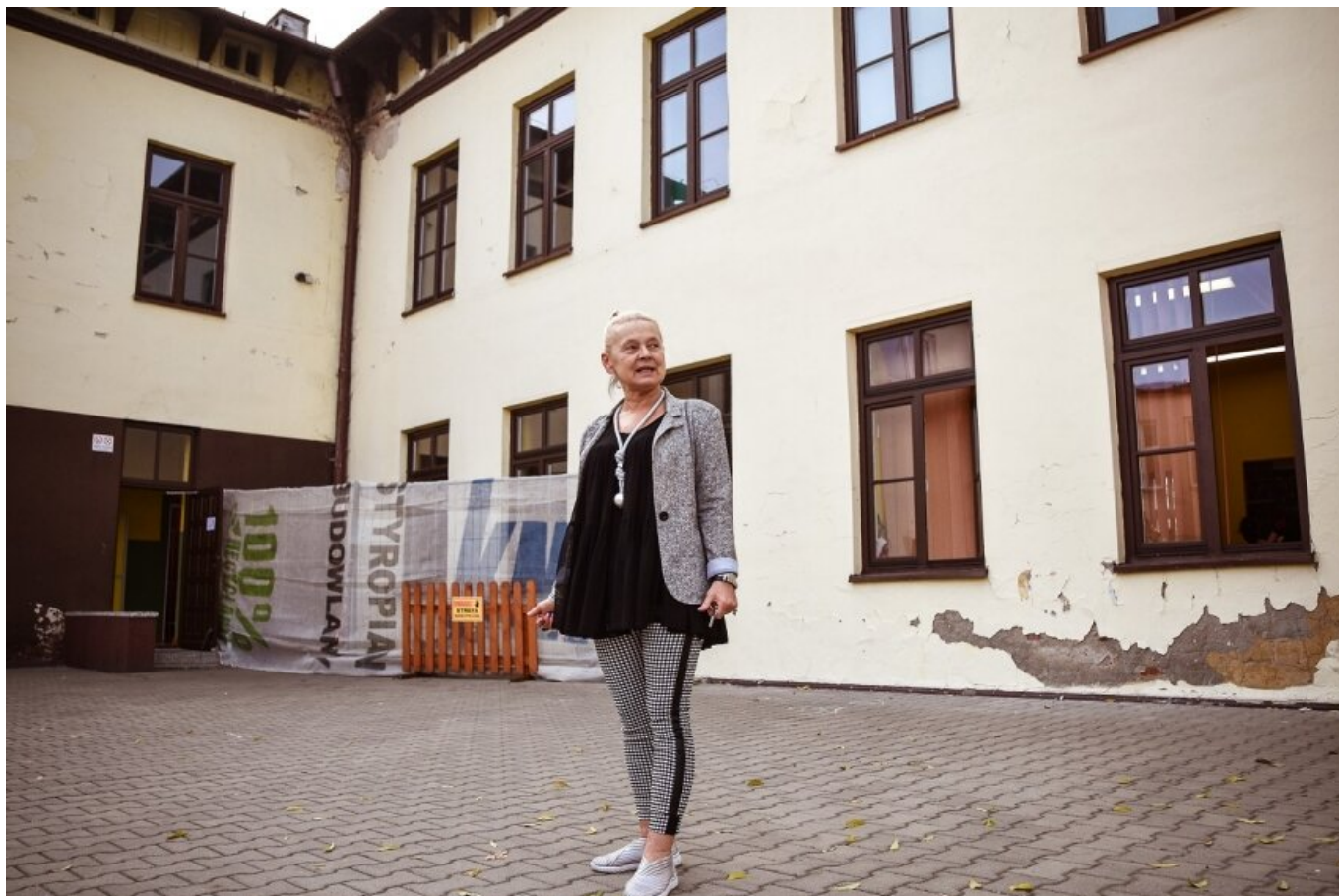
XIX-wieczny budynek Jedyńki przy ul. Sienkiewicza jest w złym stanie. (Fot. Sławomir Burzyński)
