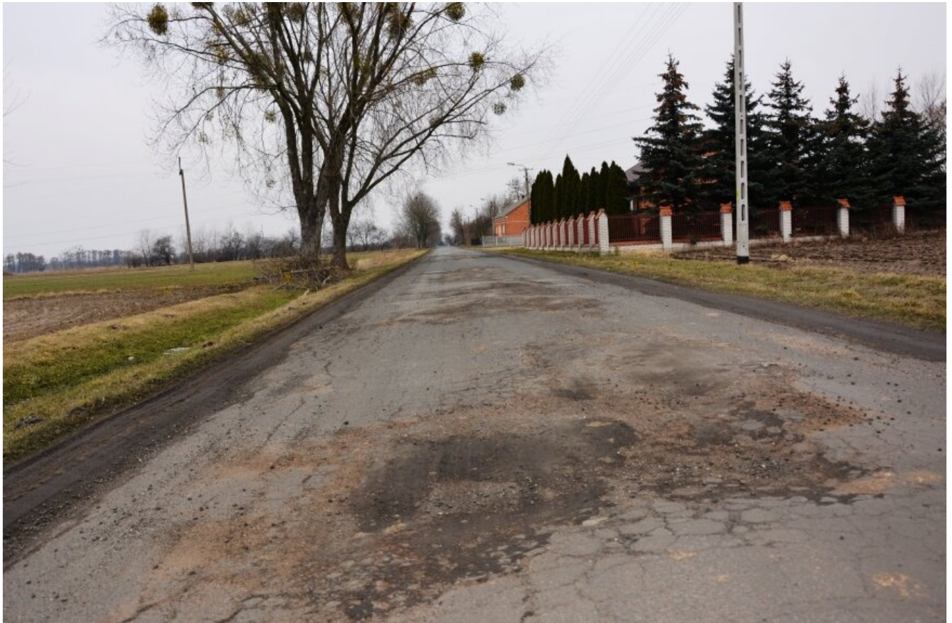
Droga powiatowa w Kurabce została zniszczona przez ciężkie samochody dojeżdżające do modernizowanej linii kolejowej. (fot. Beata Pierzchała)
