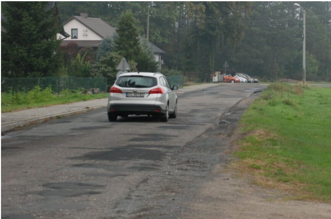
Planowana do remontu droga przebiega między innymi przez Święte. (fot. Beata Pierzchała)
